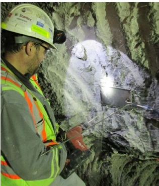
Cellules de pression NATM installées à la jonction du revêtement du tunnel en béton projeté et du terrain naturel
