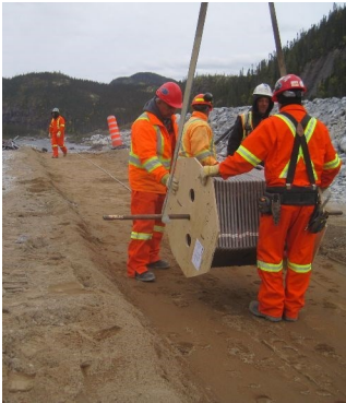
Installation de SAA horizontaux en amont.
