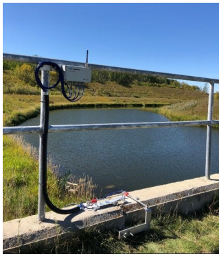
Suivi des fissures sur le mur du déversoir
