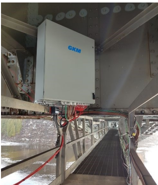
L'un des deux systèmes d'acquisition de données sur mesure installés sous le pont Alexandra.
