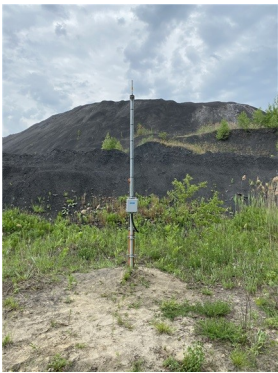
Conversion du relevé manuel du niveau d'eau en une acquisition de données automatisée
