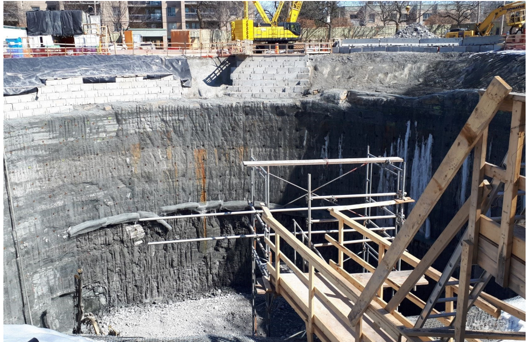
Bassin de rétention Lavigne, situé dans l'arrondissement d'Achunsiac-Cartierville près de Montréal.
