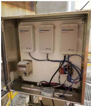
Boîtier LoRa qui collecte les données de chaque noeud
