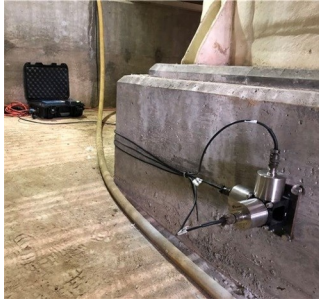
Installation SVI minimate pro accéléromètre
