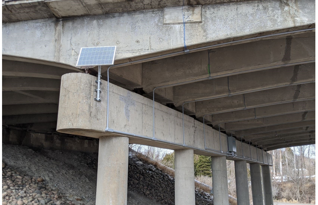
Surveillance de l'état de la santé structurale d'un viaduc au Canada
