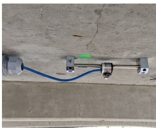
Jauge de déformation à corde vibrante attachée à la semelle d'une poutre
