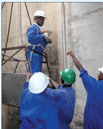
• Câble et conduit de protection
