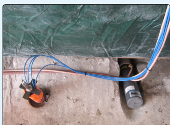
• Inclinomètre en place et extensomètre en forage incliné sous la tour McKenzie
