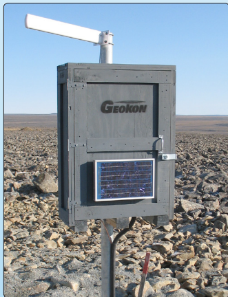
● Station de télémétrie
